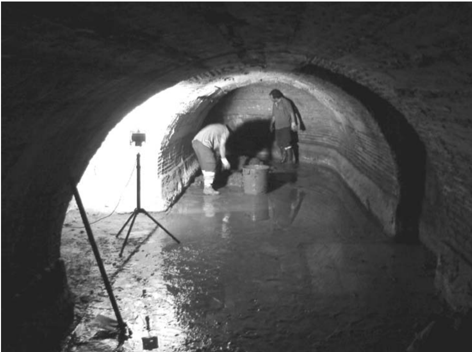
Fig. 5 – Trabalhadores da C.M.O. procedendo à remoção de lamas acumuladas na conduta de descarga da galeria das rodas hidráulicas da Fábrica de Cima.
