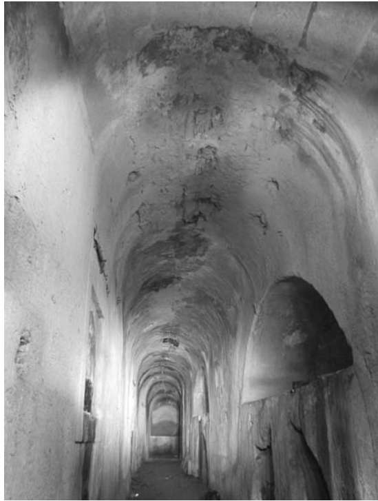
Fig. 2 – A galeria foi ampliada e remodelada, em campanha de obras posterior a 1775, de forma a alojar quatro rodas correspondentes a outros tantos engenhos de pólvora. Esta modificação alterou a estrutura inicial da galeria.
