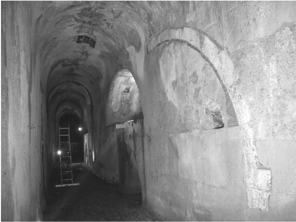
Fig. 6 – O estudo realizado permitiu identificar o posicionamento da arcaria inicial, que foi colocada a descoberto após picagem das concreções de calcário que a revestiam. O arco visível nesta foto correspondia ao segundo vão das Ferrarias, no qual se encontravam instaladas as duas rodas que movimentavam o engenho de foles e o malho pequeno (ver GOMES & CARDOSO, 2005, Fig. 12).
