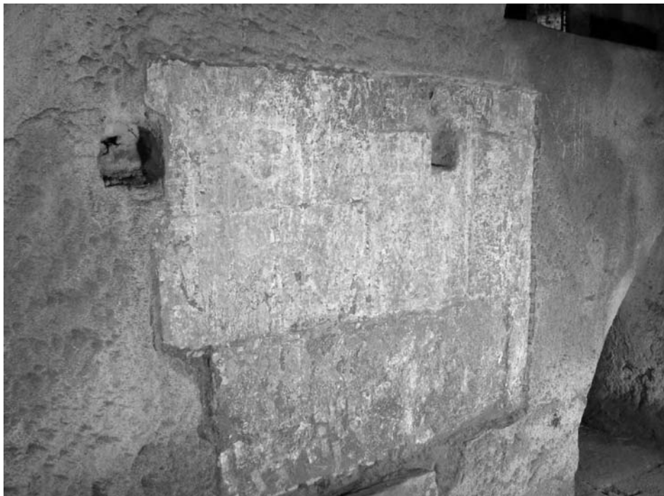
Fig. 11 – Pormenor da estrutura de apoio do eixo do engenho de verrumar, situado no vão do 3º arco.
