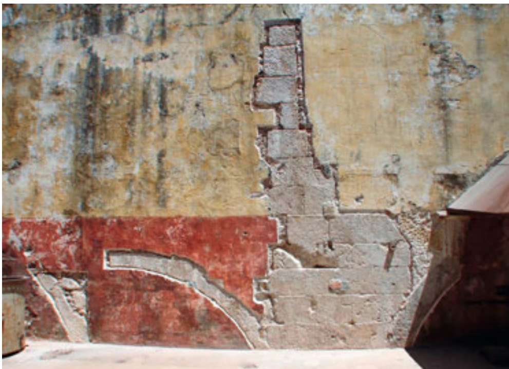
2007 – Perspectiva dos resultados dos trabalhos realizados no cunhal da galeria das rodas hidráulicas das Ferrarias d' El Rey, na Fábrica da Pólvora de Barcarena, evidenciando-se diversos elementos estruturais do edifício primitivo.
