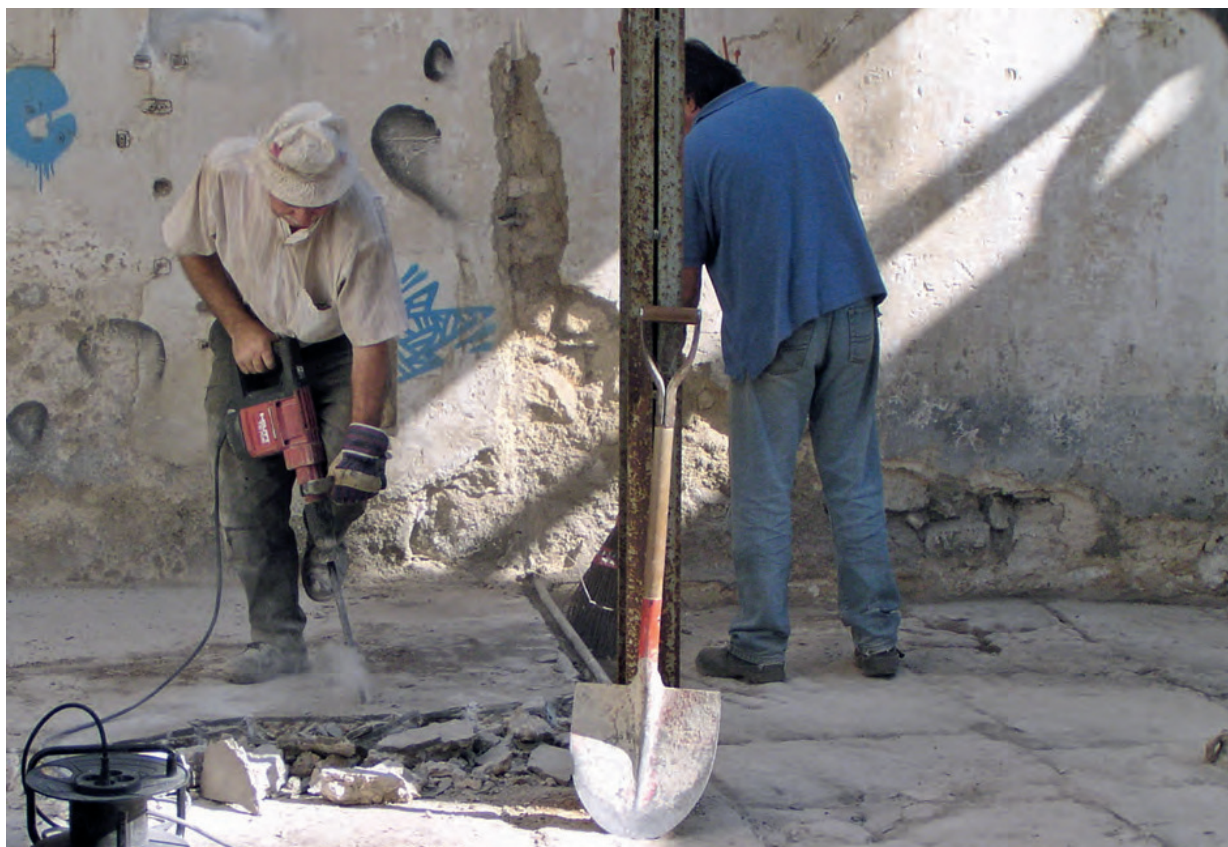
Fig. 6 – Ferrarias del Rey . Pormenor da remoção do piso de betonilha, com martelo pneumático, que forrava completamente o chão lajeado das Oficinas D e E do Edifício 33.
