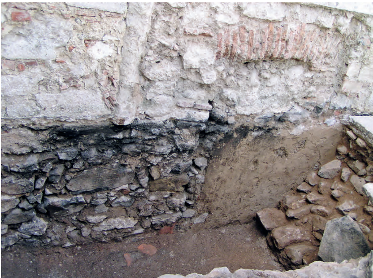
Fig. 22 – Ferrarias del Rey . Vista parcial do interior da parede poente do edifício primitivo, evidenciando-se a diferença de rebocos entre o sector correspondente à porta entaipada e a parede adjacente. Observe-se um dos muros contraventados que contribuíam para a estabilidade da abóbada do engenho de galgas, construídos entre o exterior desta e a parede do edifício (ver Figs. 4 e 13).
