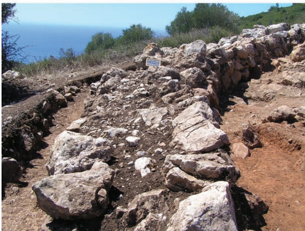
Fig. 32 – Outeiro Redondo. Em cima: vista do lado interno de sector da Muralha G voltado a Sul, posta a descoberto em 2013, evidenciando-se a má qualidade do aparelho construtivo do paramento, constituído por blocos heterométricos e muito irregularmente dispostos, assentes ora no substrato natural de “terra rossa”, ora em depressões preenchidas com espólios do final do Calcolítico Inicial. Em baixo: vista do mesmo sector da Muralha G, cuja escavação se concluiu em 2014, arqueando progressivamente, acompanhando a topografia do terreno, evidenciando-se a respectiva técnica construtiva (fotos de J. L. Cardoso).
