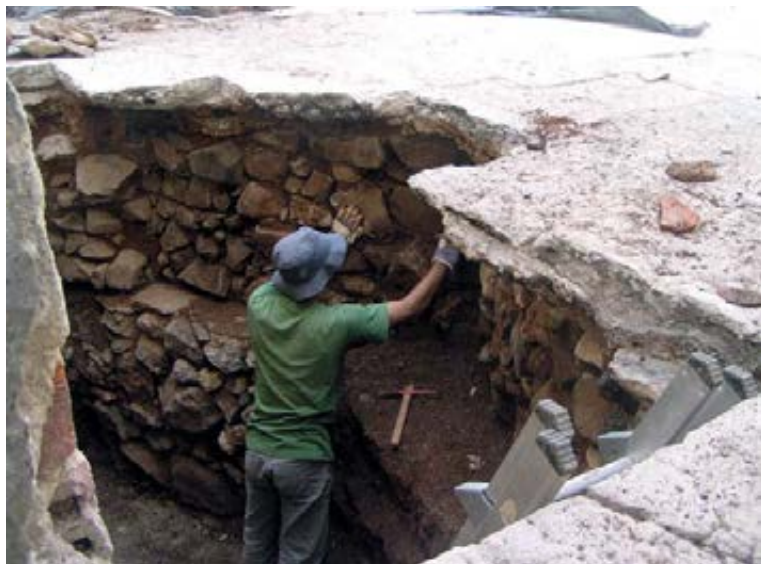
Fig. 7 – Vista parcial da escavação efectuada no edifício das Ferrarias em 2009, sob direcção do signatário. Observa-se a parede externa da abóbada de alvenaria da câmara enterrada onde se instalaram os maquinismos de transmissão de movimento às galgas, sob o piso lajeado então construído. Foto de J. L. Cardoso.
