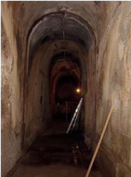
Fig. 6 – Vista do interior da galeria do edifício das Ferrarias, observando-se o prolongamento da galeria das Ferrarias relacionado com a ampliação efectuada no último quartel do século XVIII, com orientação ligeiramente distinta. Foto de F. Martins.
