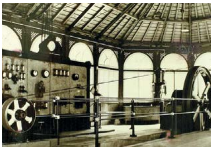
Fig. 47 – Central de produção de energia eléctrica de 1924, a partir de um motor Diesel DEUTZ. Arquivo CMO. Reprodução fotográfica de J. L. Cardoso.
