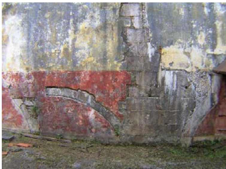
Fig. 5 – Parede setentrional do antigo edifício das Ferrarias evidenciando a existência de duas fases construtivas, a mais antiga correspondente à edificação e utilização do edifício como Ferrarias, a mais recente correspondente ao acrescento realizado no último quartel do século XVIII relacionado com a adaptação a fábrica a pólvora (a “Fábrica de Cima”). Nota-se a interrupção dos arcos relacionados com a localização das roda das azenhas das Ferrarias, pelos construídos no século XVIII e ainda o remate em excelente alvenaria aparelhada de blocos calcários do edifício das Ferrarias e do respectivo canal, depois acrescentado Foto de J. L. Cardoso.
