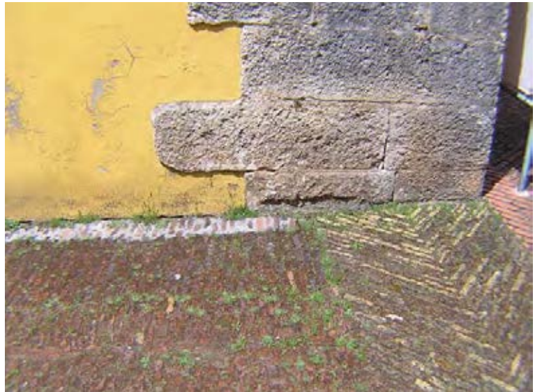
Fig. 76 – Pavimento constituído por tijolos colocados de cutelo, em espinha, para evitar o risco de faíscas, conservado no corredor circundante da “Fábrica de Baixo”. Foto de J. L. Cardoso.
