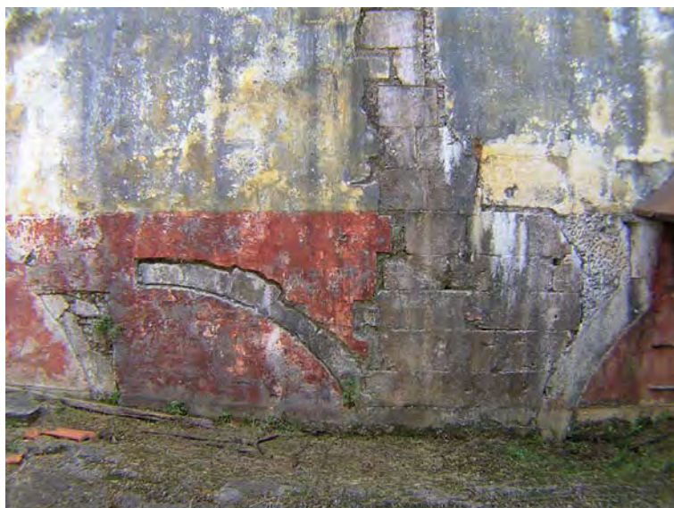
Fig. 5 – Parede setentrional do antigo edifício das Ferrarias evidenciando a existência de duas fases construtivas, a mais antiga correspondente à edificação e utilização do edifício como Ferrarias, a mais recente correspondente ao acrescento realizado no último quartel do século XVIII relacionado com a adaptação a fábrica da pólvora (a “Fábrica de Cima”). Nota-se a interrupção dos arcos relacionados com a localização das roda das azenhas das Ferrarias, pelos construídos no século XVIII e ainda o remate em excelente alvenaria aparelhada de blocos calcários do edifício das Ferrarias e do respectivo canal, depois acrescentado no século XVIII. Foto de J. L. Cardoso.
