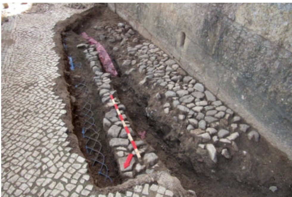
Fig. 16 – Calçada [330] afectada por duas infraestruturas.
